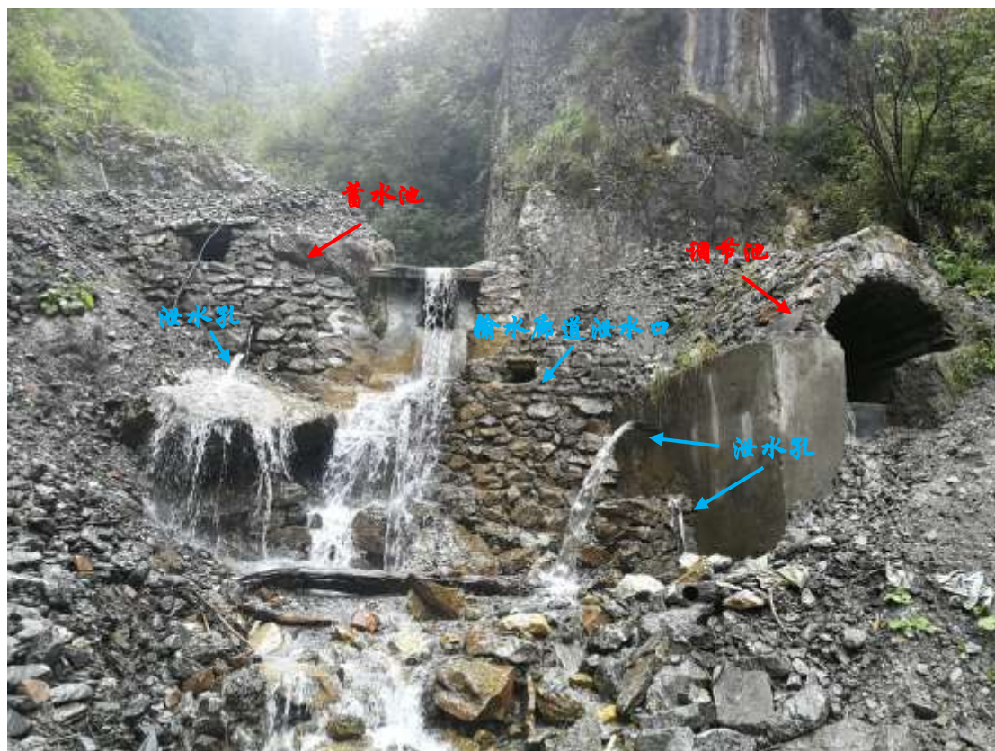
照片 5-1 水源地蓄水池与调节池
